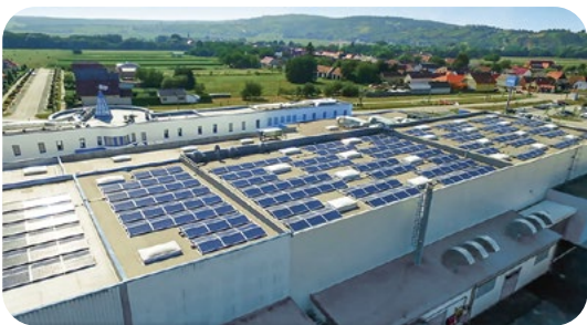
Die Photovoltaik-Anlage unseres Werks in Ungarn
